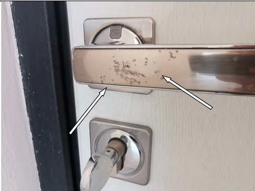
Фото №44. Загрязнения на фурнитуре входного дверного блока.
