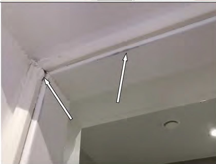
Фото №39. Загрязнение коробки деревянного дверного блока в ванной комнате.
