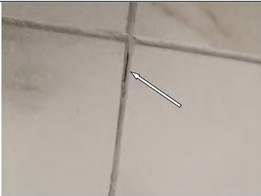
Фото №21. Неполное заполнение шовного пространства напольной керамической плитки затирочным составом в кухне.
