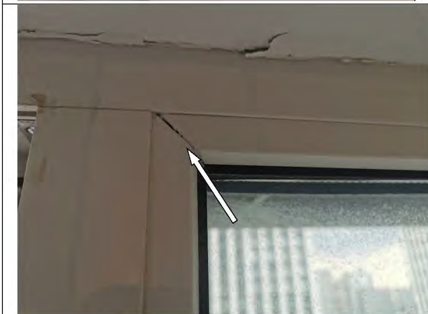
Фото №29. Зазоры в месте соединения профилей ПВХ оконного блока в комнате.
