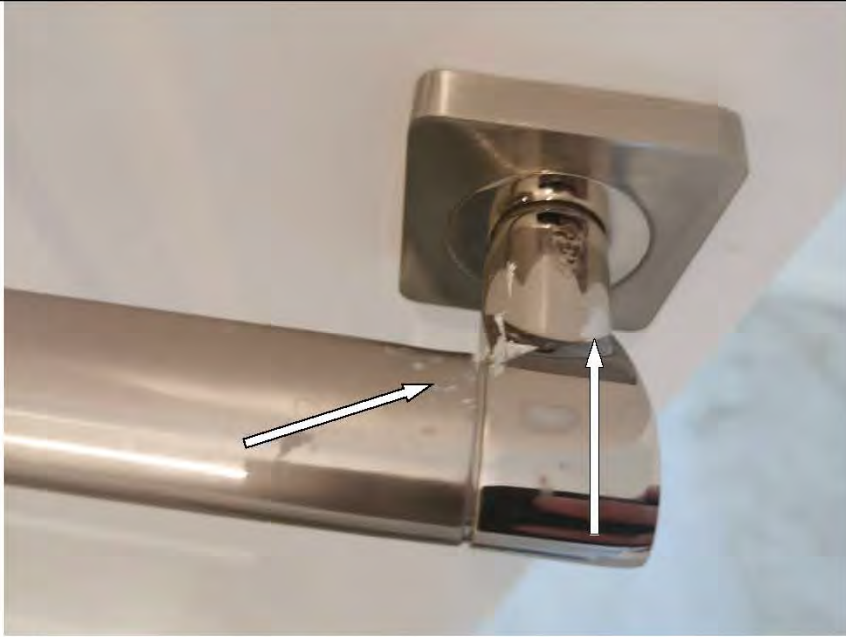
Фото №43. Загрязнения на фурнитуре деревянного дверного блока в ванной комнате.
