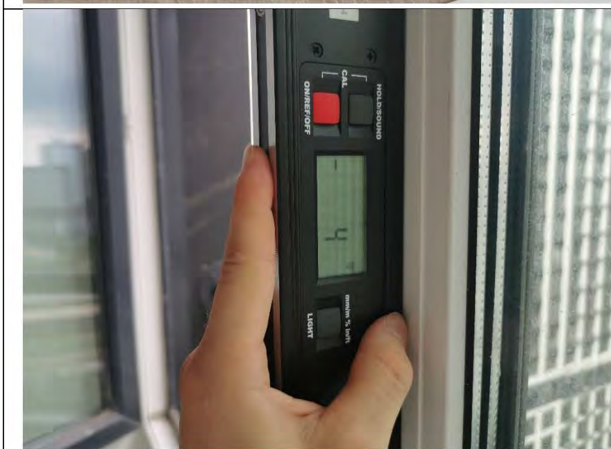
Фото №27. Отклонение ПВХ оконного блока в комнате по уровню вертикальности.
