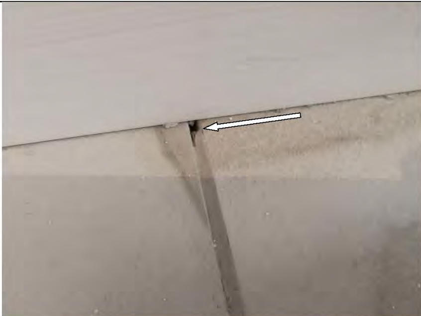
Фото №20. Неполное заполнение шовного пространства напольной керамической плитки затирочным составом в коридоре.
