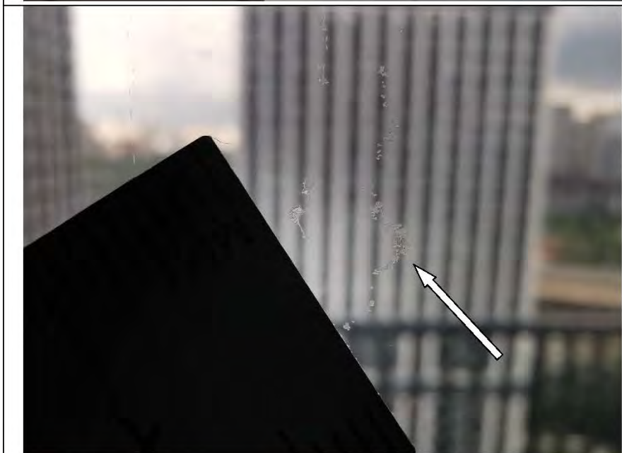
Фото №32. Окалины на стеклопакете оконного блока ПВХ в комнате.
