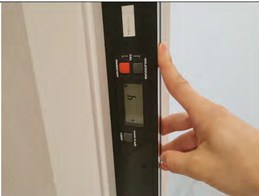
Фото №38. Отклонение коробки деревянного дверного блока от уровня вертикальности в ванной комнате.
