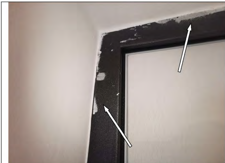
Фото №40. Загрязнение коробки входного дверного блока.
