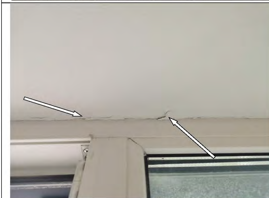
Фото №35. Окрашенные откосы оконного блока ПВХ выполнены с дефектами.
