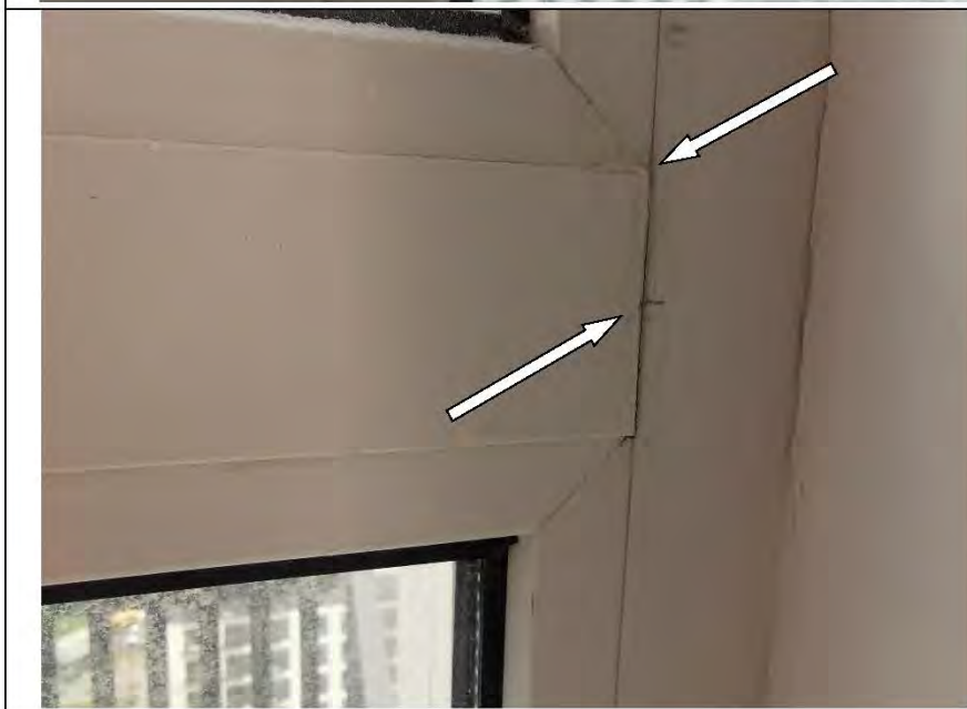
Фото №30. Загрязнение профиля ПВХ оконного блока в комнате.
