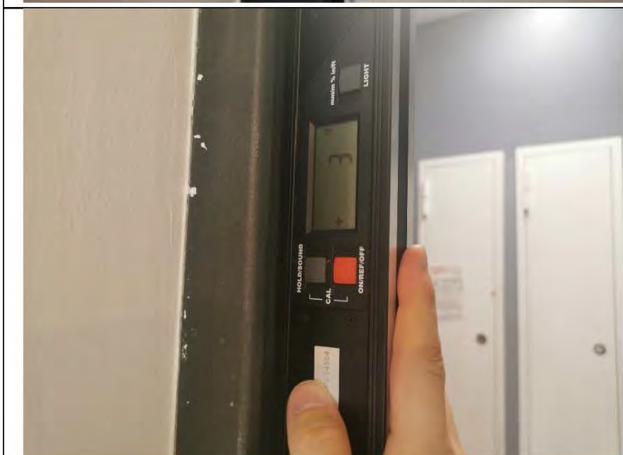
Фото №41. Отклонение коробки входного дверного блока.
