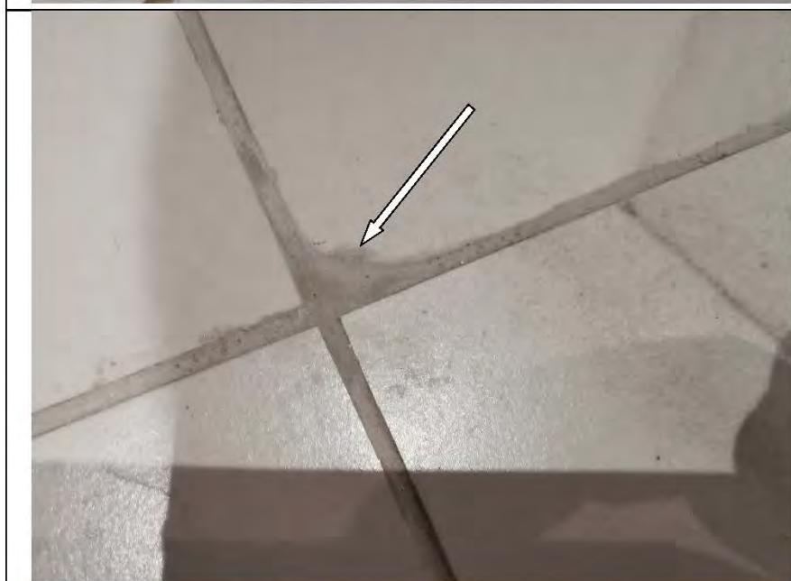
Фото №23. Загрязнение затирочным раствором напольной керамической плитки ванной комнате.
